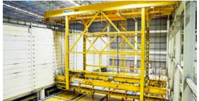
Curing : ระบบการบ่มคอนกรีตอัตโนมัติ ควบคุมเวลาจากระบบ Master Computer
